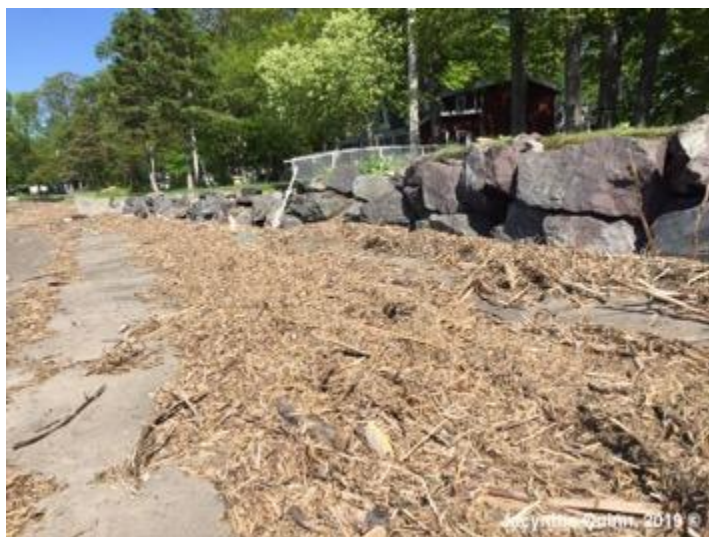
Figure 56 : Un enrochement anthropique sur un terrain privé à la municipalité de Saint-Michel-de-Bellechasse, Québec.
