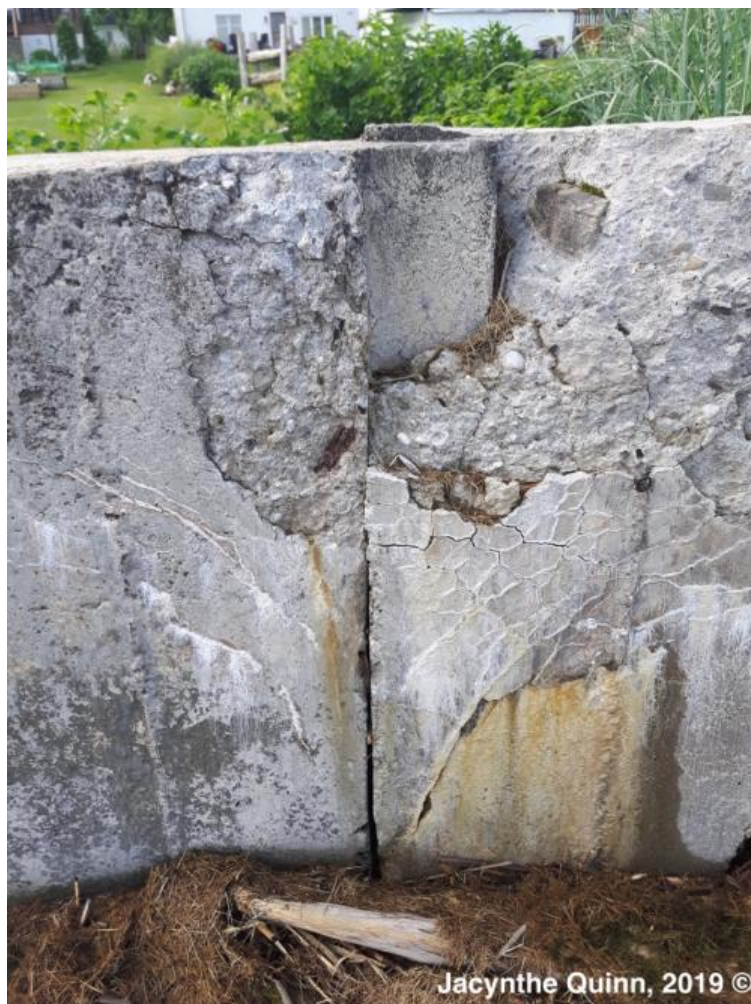
Figure 61 : Fissures ou cassure dans un muret de béton avec de la dégradation du muret sur une propriété privée créée par les grandes marées, Saint-Michel-de-Bellechasse, Québec.
