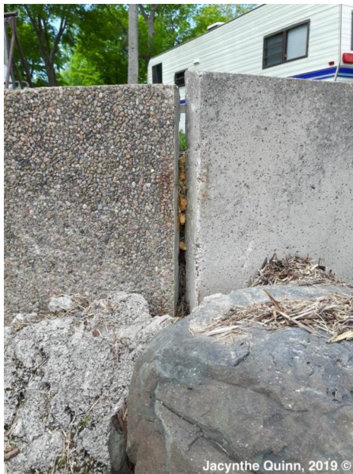
Figure 62 : Séparation de deux murs en béton dans le secteur du Camping la Tasserie à Saint-Michel-de-Bellechasse, Québec.
