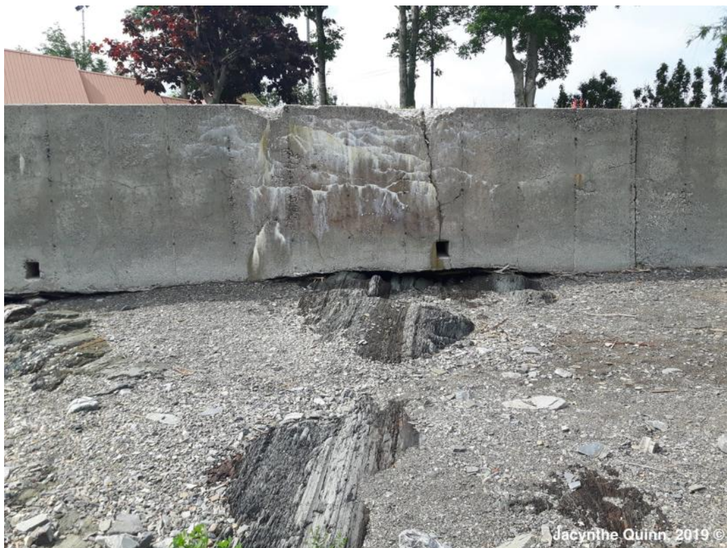
Figure 63 : Fissures dans un mur de béton avec des signes de réparation ancienne sur une propriété privée créée par les grandes marées, Saint-Michel-de-Bellechasse, Québec.
