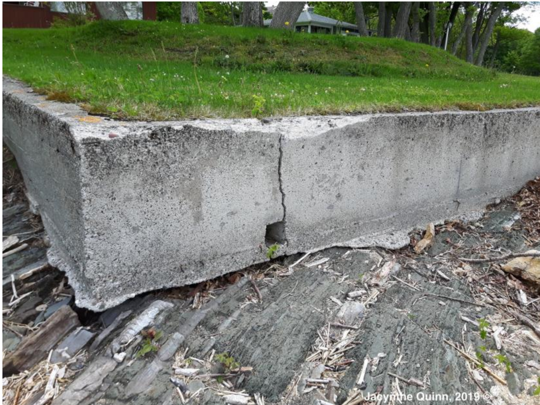
Figure 60 : Fissure dans un muret de béton sur une propriété privée créée par les grandes marées, Saint-Michel-de-Bellechasse, Québec.
