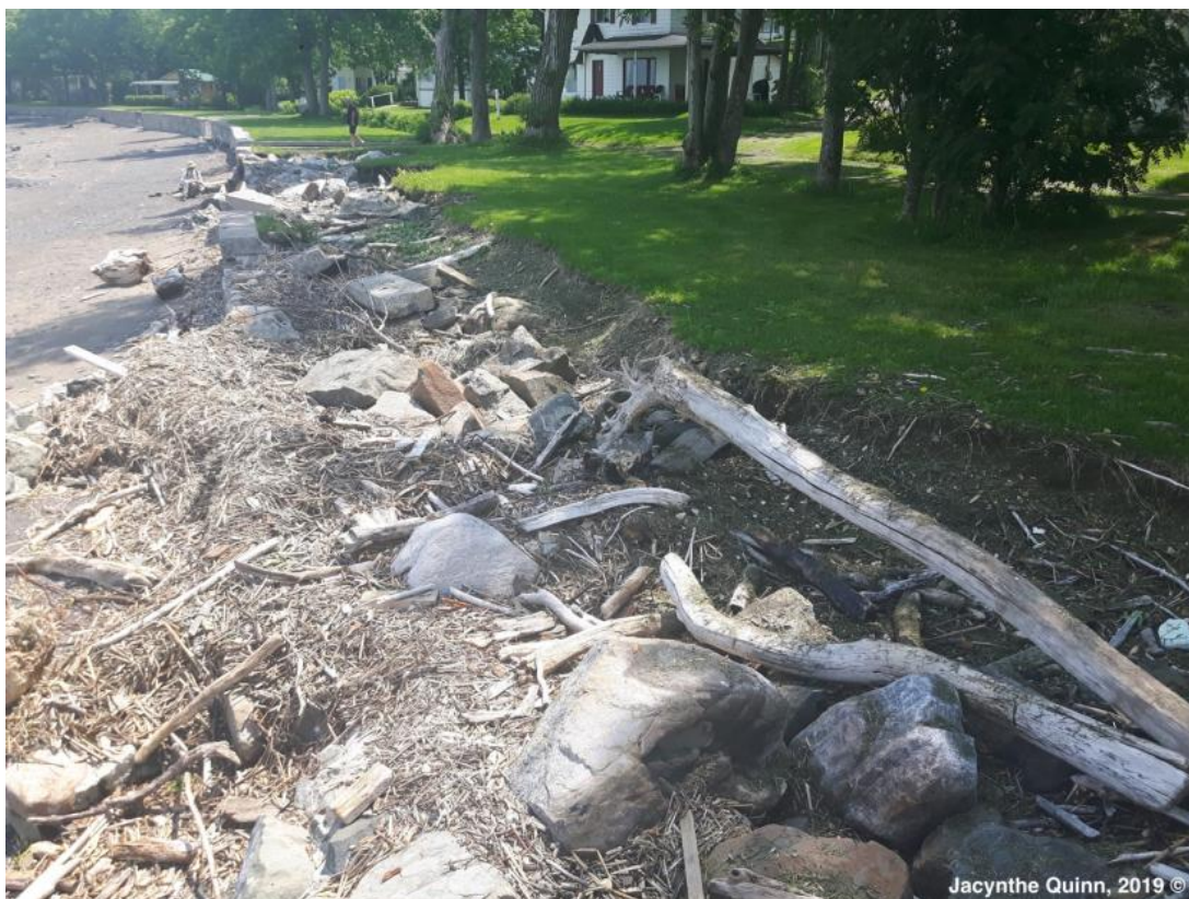
Figure 48 : Enrochement détruit causé par l'érosion côtière sur un terrain privé à la municipalité de Saint-Michel-de-Bellechasse, Québec.
